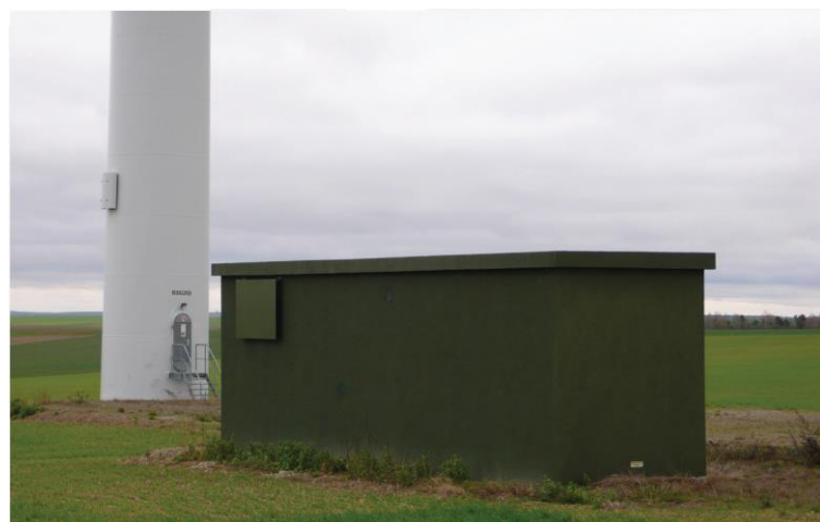
Figure 74 : Exemple de poste de livraison (Source : Epure Paysage)
