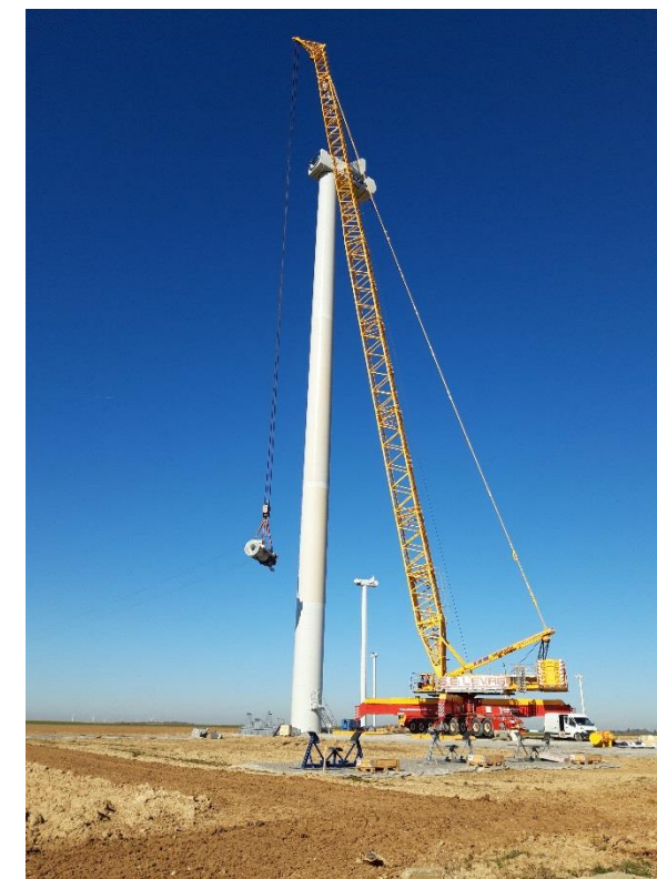
Figure 57 : Montage de la génératrice (Source : VOLKSWIND)
