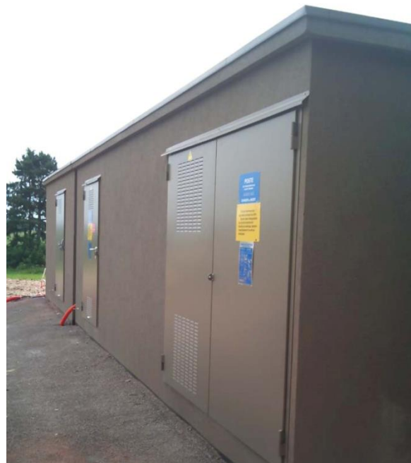
Figure 44 : Exemple de poste de livraison
